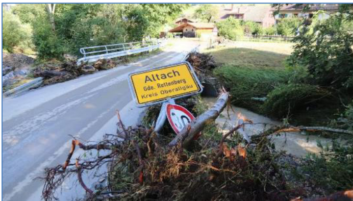
Abbildung 50: Unterspülte Straße im Jahr 2021. Quelle: Allgäuer Zeitung (2021).
