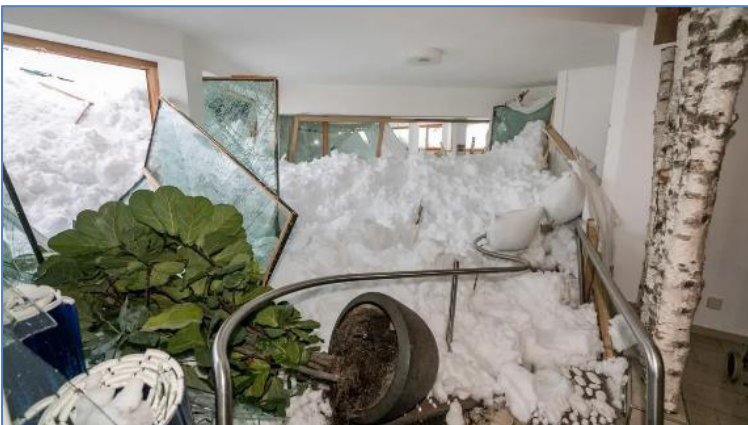
Abbildung 58: Schwere Lawinenschäden im Hotel Hubertus in Balderschwang im Jahr 2019. Quelle: Allgäuer Zeitung (2019).
